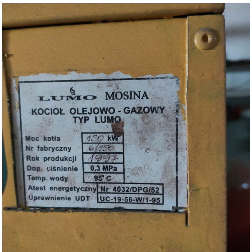
Widok jednego z kotłów olejowych
