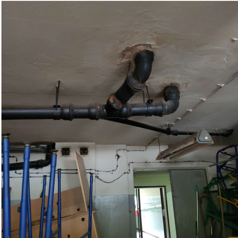
widok kanalizacji w pomieszczeniach piwnicy
